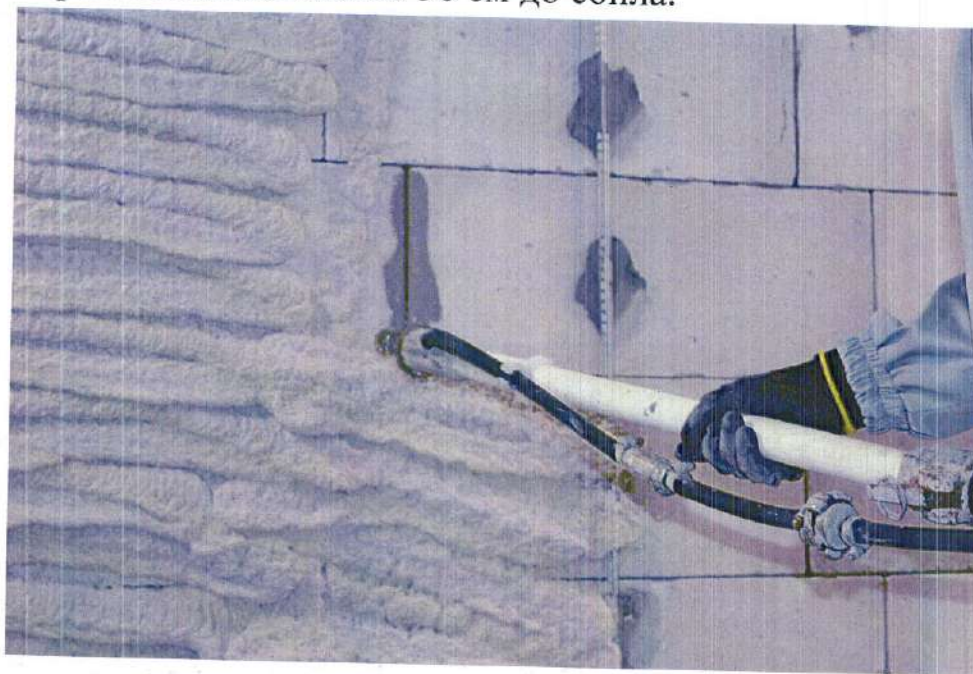
Рисунок 26 – Нанесение штукатурной смеси «ilmax thermo теплая стена 3D» с помощью штукатурной станции
